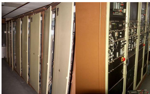
Fig.8 - Dulapurile de comandă - 12 (8 - partea din spate și 4 - partea din față)
