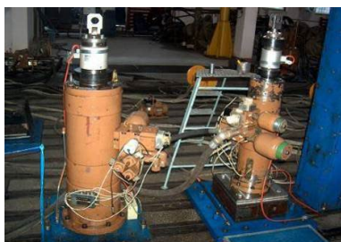
Fig.6 - Cilindri hidraulici, dispuși pentru acționarea pe verticală
