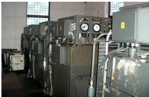
Fig.4 - Agregatele de pompare
