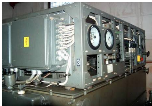
Fig.5 - Sistemul de monitorizare la agregatele de pompare
