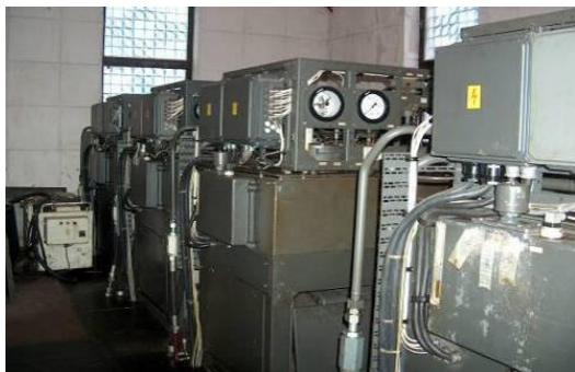
Fig.4 - Agregatele de pompare
