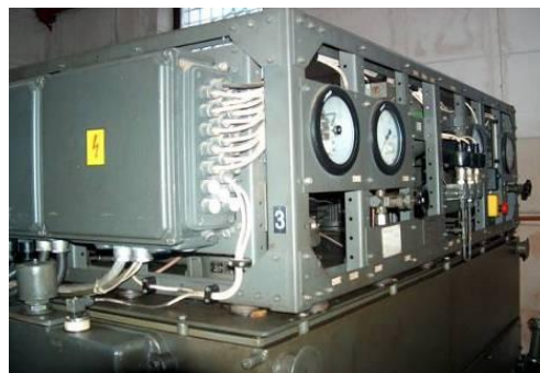
Fig.5 - Sistemul de monitorizare la agregatele de pompare
