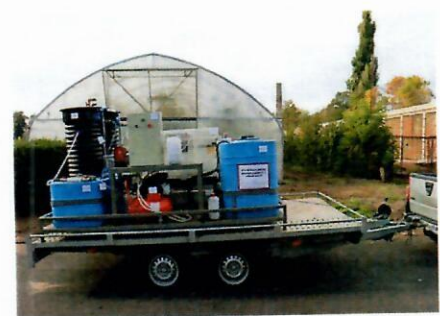
Stația modulară mobilă de epurare a apelor uzate
