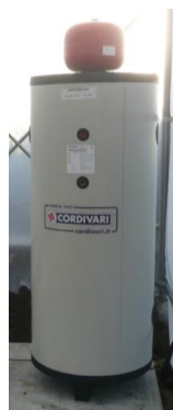
Fig. 4. Rezervorul de apă rece 500 l și vasul de expansiune 24 l
