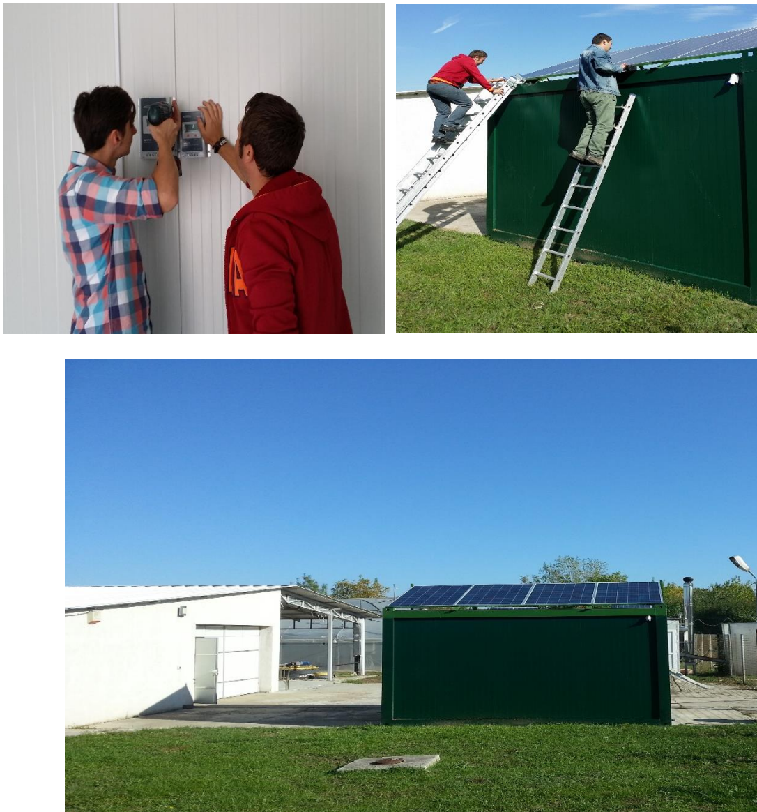
Fig. 29. Sistemul de panouri fotovoltaice
