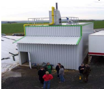
Fig. 3. Digestoare orizontale cu flux lent “EUCO®”, ale Schmack Biogas, cu un volum de 400 m 3 (RUTZ, 2008)
