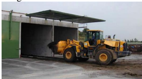
Fig. 1. Digester cu funcționare discontinuă de tip garaj, încărcat cu ajutorul buldozerului [3]
