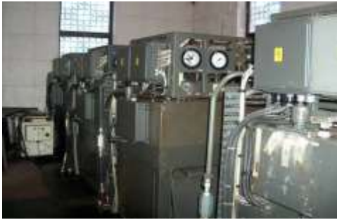
Fig. 2 - Agregatele de pompare
