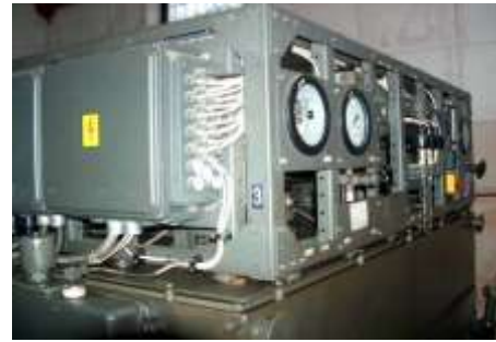
Fig. 3 - Sistemul de monitorizare la agregatele de pompare
