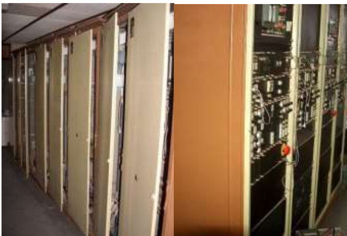
Fig. 6 - Dulapurile de comandă - 12 (8 - partea din spate și 4 - partea din față)
