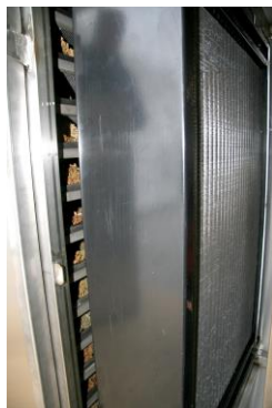
Fig.6 – Baterie de radiatoare
