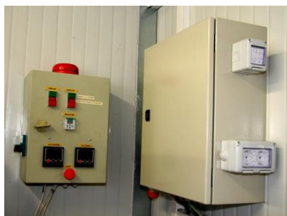
Fig.9 – Instalație electrică de comandă și control
