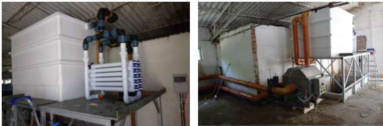
Fig. 3,4 – Amplasarea filtrului biologic FB 2,4 la locul de încercare
