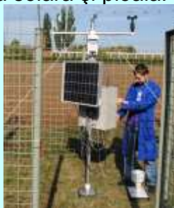
a. Stația meteo
