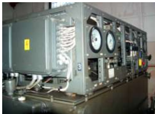
Figura 3 - Sistemul de monitorizare la agregatele de pompare
