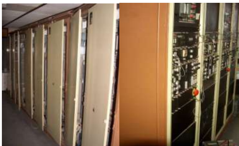
Figura 6 - Dulapurile de comandă - 12 (8 - partea din spate și 4 - partea din față)
