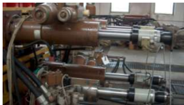
Figura 5 - Cilindrii hidraulici, dispuși pentru acționarea pe orizontală
